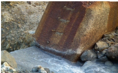
(図3: 座屈変形した不安定な岩塊) (地獄谷右岸側)
